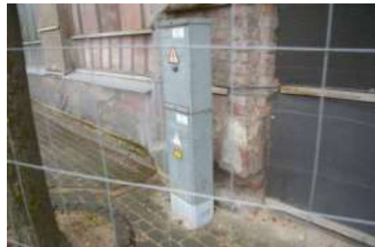
Dzīvojamā ēka ar kadastra apzīmējumu 6405 007 0006 001, elektropievads/sadales skapis
